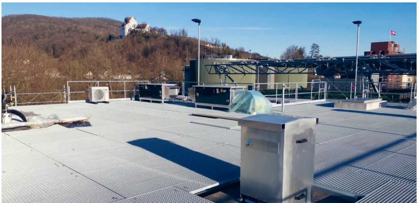
Die Gitterroste garantieren ein sicheres Arbeiten an den Aggregaten und Einrichtungen auf dem Dach.
