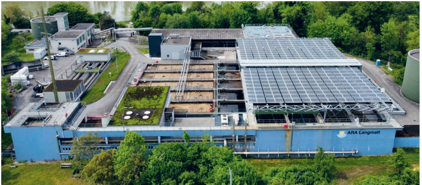
Vor der Sanierung wies die Südfassade Mängel und Schäden auf.
