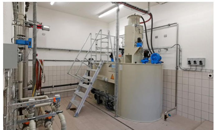
Die neue Polymerlösestation mit sicherem Treppenaufstieg und Podest.
