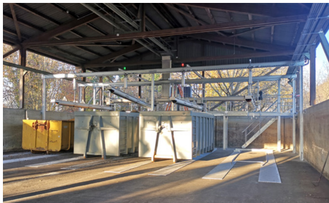
Der neue Muldenbahnhof garantiert minimale Geruchsemissionen.
