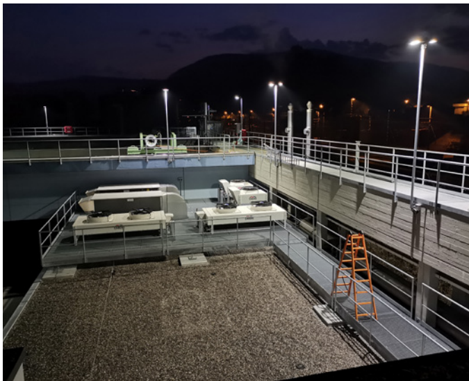
Optimale Arbeitssicherheit: Die Podeste der Aussenanlagen sind mit Geländern ausgerüstet, die LED Beleuchtung reduziert die Lichtverschmutzung.
