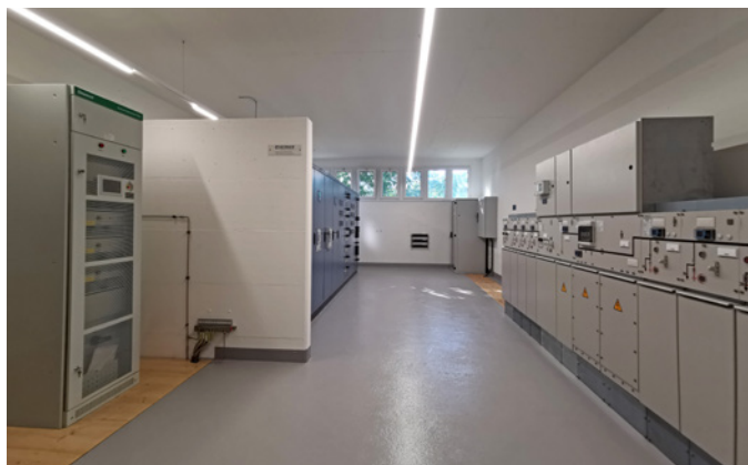
Die Hauptverteilung ist umgebaut. Hinten links: Niederspannungshauptverteilung, vorne rechts: Mittelspannungshauptverteilung, vorne links: Oberwellen Aktivfilter und Kompensation für ein sauberes Netz.
